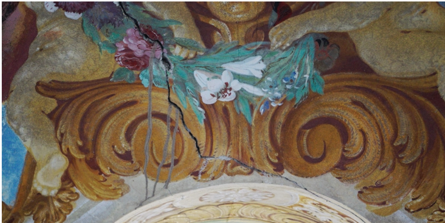
Obrázek 033: Sál předků na zámku Vranov nad Dyjí, detail praskliny ve zdivu.
