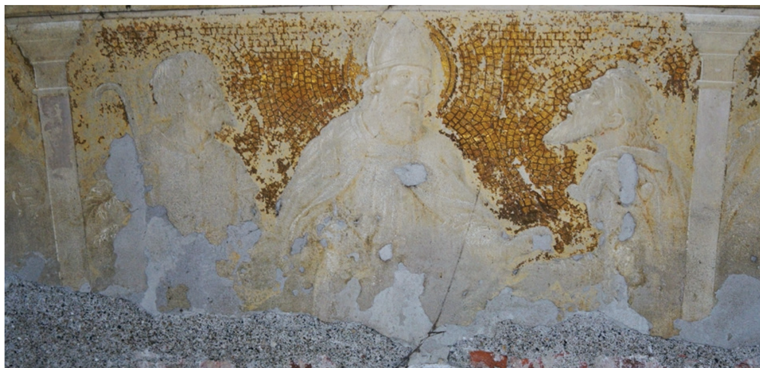
Obrázek 031: Mauzoleum rodu Kleinů v Sobotíně, detail degradované výmalby se sv. Vojtěchem.
